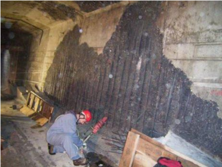
Paroi de tunnel après incendie
