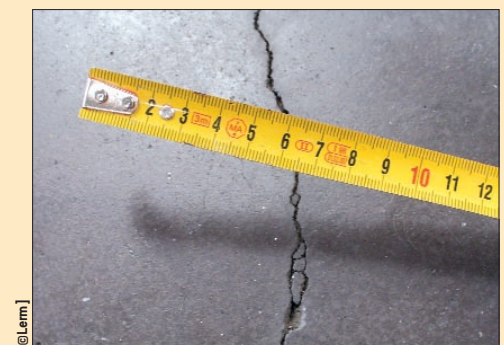
Fig. 3 – Ouverture importante des fissures de retrait.
