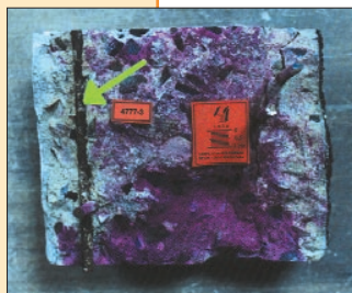
Fig 5 et 6 • Carbonatation le long des fissures avec armatures corrodées (soulignées par les flèches vertes).
