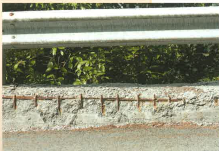
Fig. 2 Corrosion des armatures consécutive à la fragilisation du béton d'enrobage et à l'utilisation des sels de déverglaçage.
