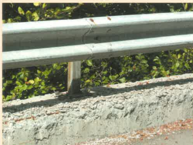
Fig. 1 Ecaillage du béton sous l'action combinée des cycles de gel/dégel et des sels de déverglaçage.
