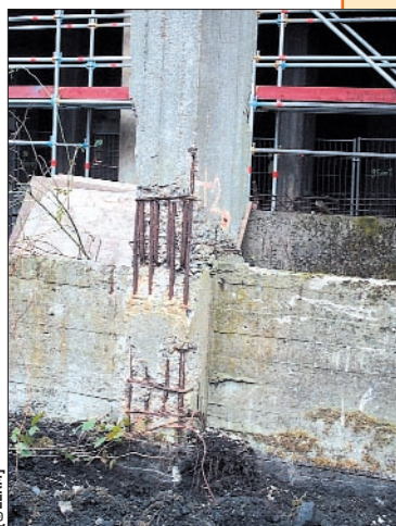
◀ Corrosion par carbonatation sur un départ de poteau.
