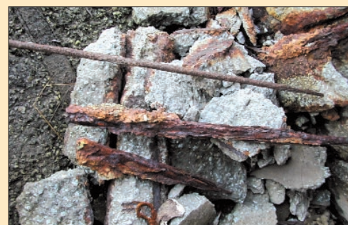
▲ En se corrodant, les aciers augmentent de volume (en bas), comparé à une armature saine (en haut).
