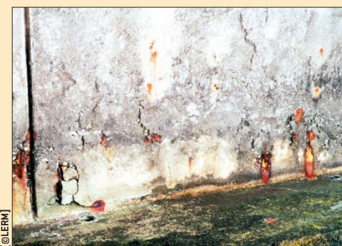
▲ Corrosion par piqûres liées aux chlorures.
