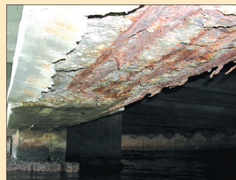
▼ Corrosion importante en sous-face d'une poutre de pont.
